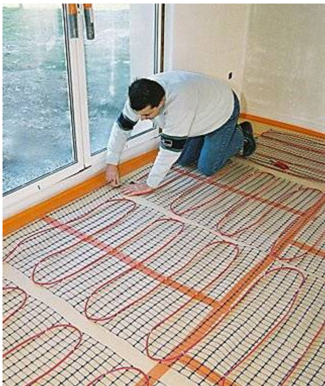
Električno podno grejanje
